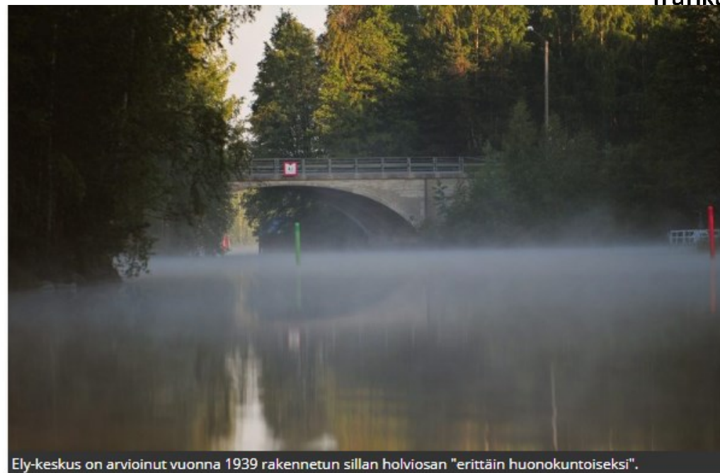
Ely-keskus on arvioinut vuonna 1939 rakennetun sillan holviosan "erittäin huonokuntoiseksi".
