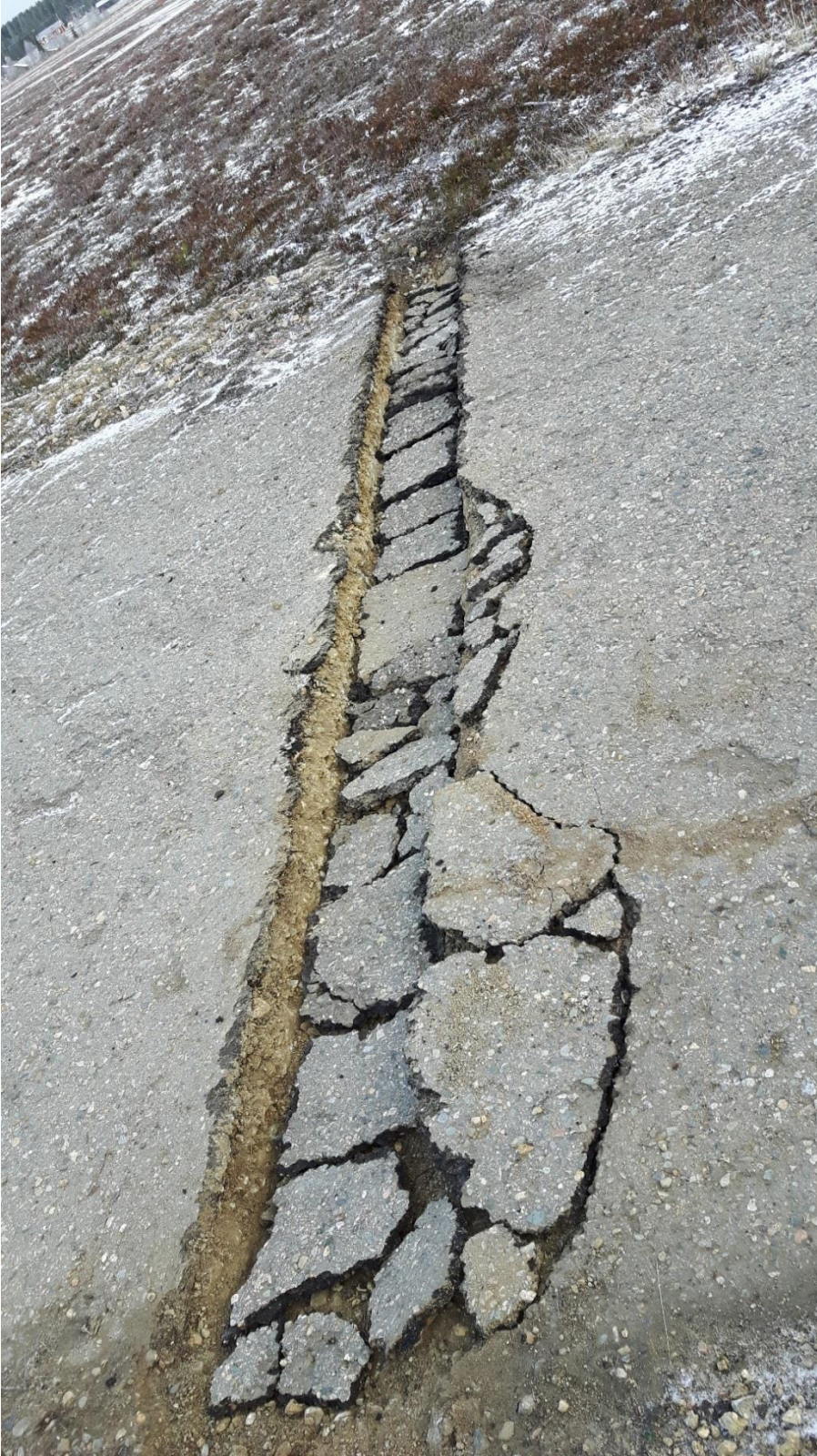
Kuva 12. Painauma viimevuotisten KEKO ja KUOPPA vaurioiden välissä.
