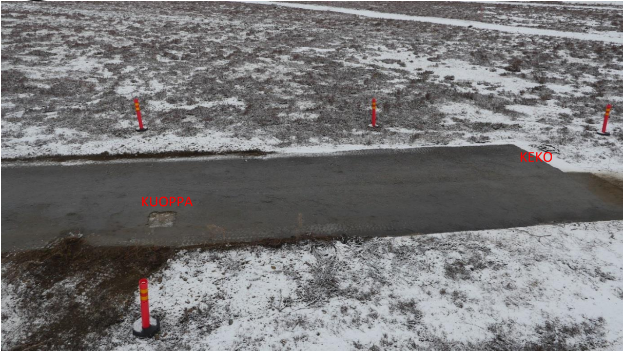
Kuva 8. Routavauriot KUOPPA ja KEKO
